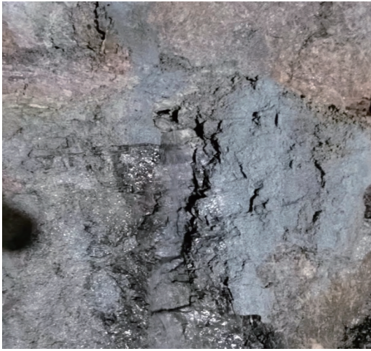
图 12 隧道初支渗漏水
