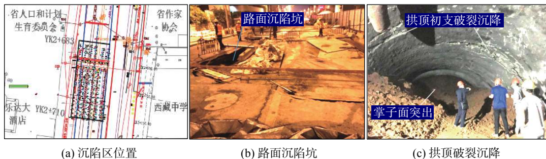
图 1 路面沉陷及拱顶破裂沉降情况
