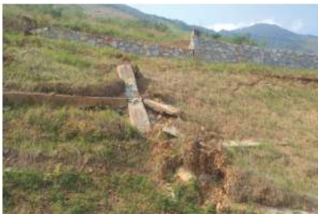
图 1 现场坡体框架梁破坏情况
