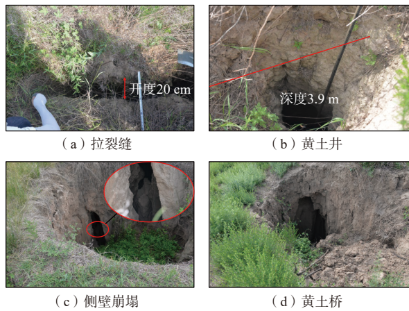
图 1 泾阳南塬塬边典型裂缝和潜蚀洞穴
